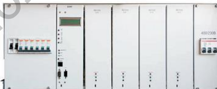
Рис. 26. Внешний вид системы электропитания ПС-60/48
