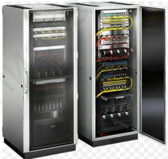
Рисунок 36 – Телекоммуникационный шкаф с установленным оборудованием
