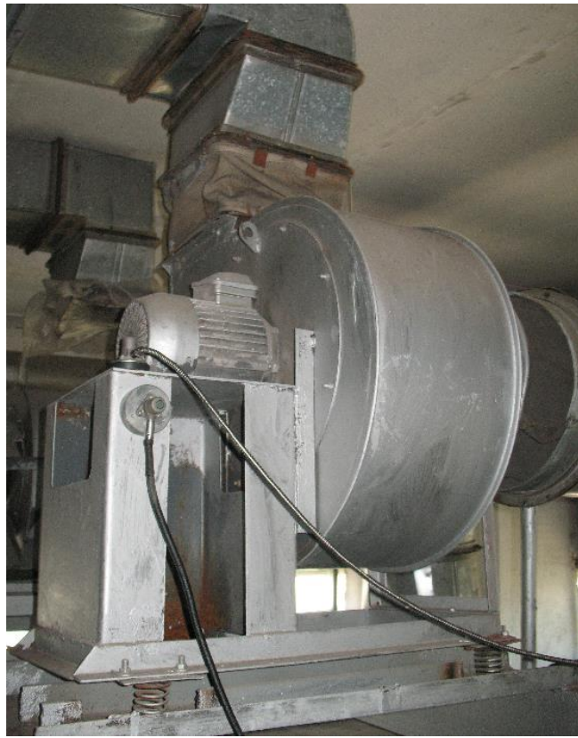
Рисунок 5.23 – Установка на магнитах виброизмерительных преобразователей при анализе вибрационного состояния вентиляционной системы
