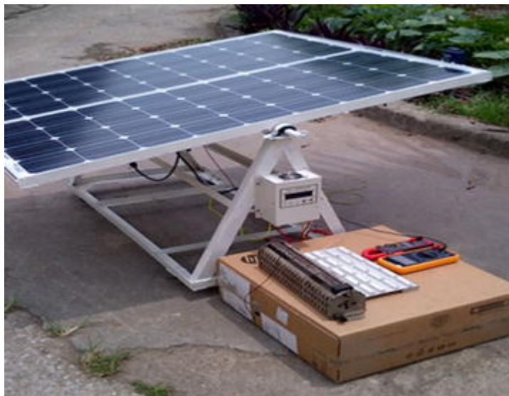
Рисунок 2. Установка солнечной панели DS-100M
